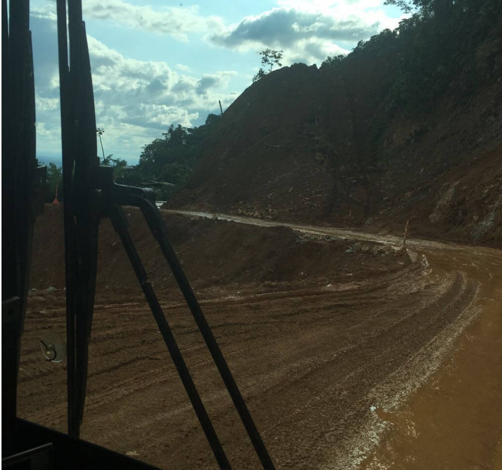
Así está la vía Quibdó-
